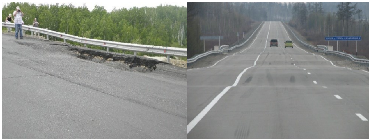
Рис. 2. Деформации дорожной конструкции на участке трассы «Амур» Чита – Хабаровск в Забайкальском крае
