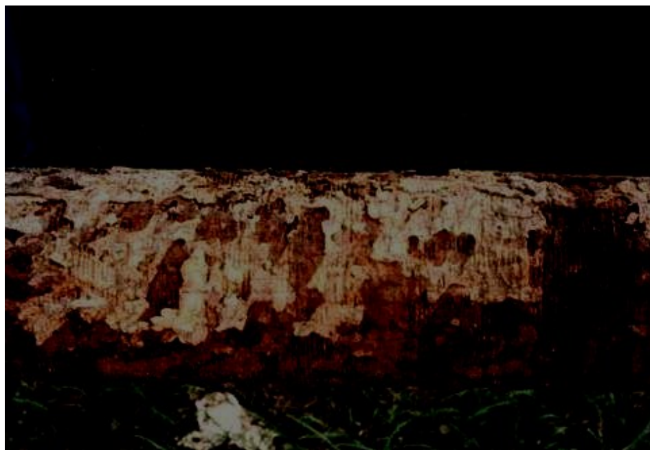
Рис. 3. Отложения на фильтре артезианской скважины Fig. 3. Deposits on the filter of an artesian well
