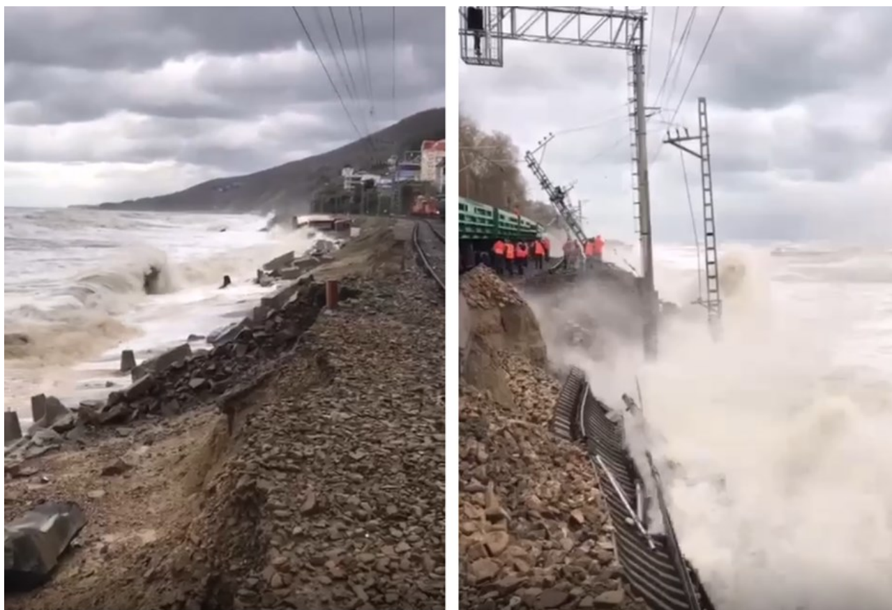
Рис. 3. Вид объекта в случае реализации сценария наиболее тяжелой аварии на берегозащитном гидротехническом сооружении (обрушение подпорно-волноотбойной стены) Fig. 3. Type of object in case of realization of the scenario of the most severe accident on a coastal protection structure (collapse of a sea wall)
