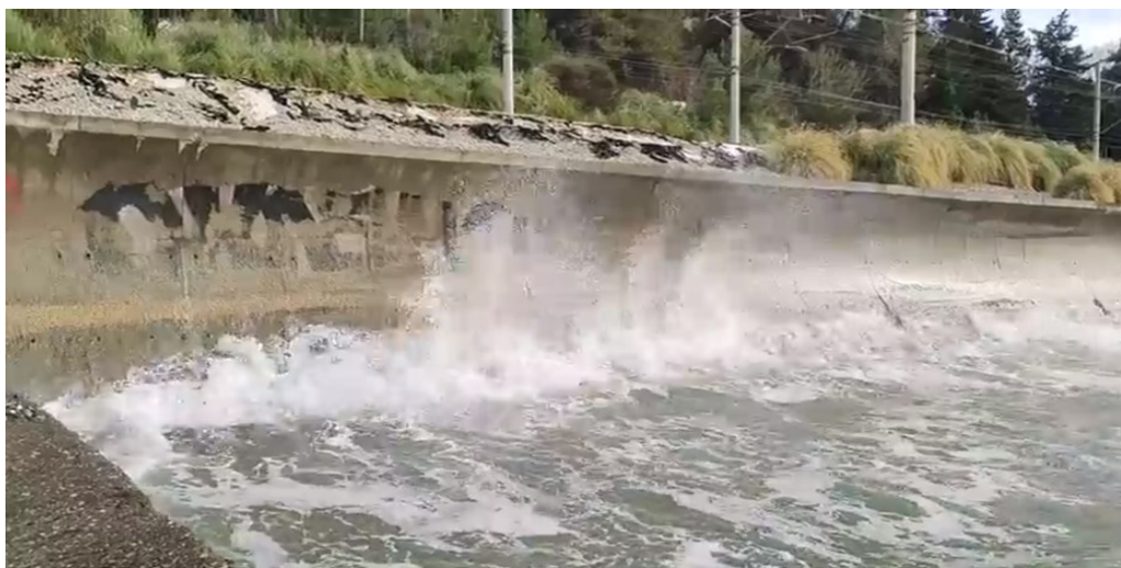
Рис. 2. Вид объекта в случае реализации сценария наиболее вероятной аварии на берегозащитном гидротехническом сооружении (размыв волногасящей полосы) Fig. 2. Type of object in case of realization of the scenario of the most probable accident on the coastal protection structure (beach erosion)
