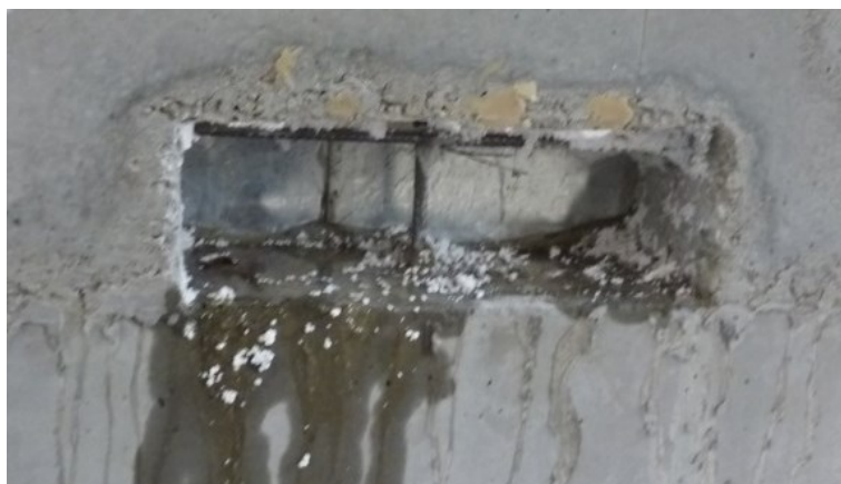
Рис. 13. Протечка воды при соединении металлической гидрошпонки на эпоксидном клее Fig. 13. Water leaks when connecting a metal waterstop with epoxy adhesive
