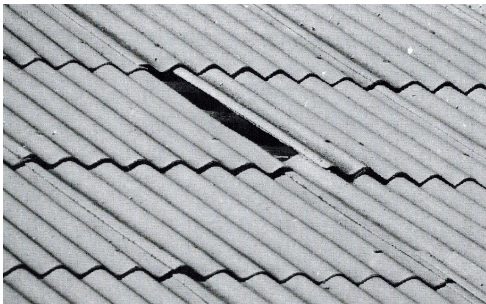
Рис. 5. Разрушение кровли Fig. 5. Roof collapse
