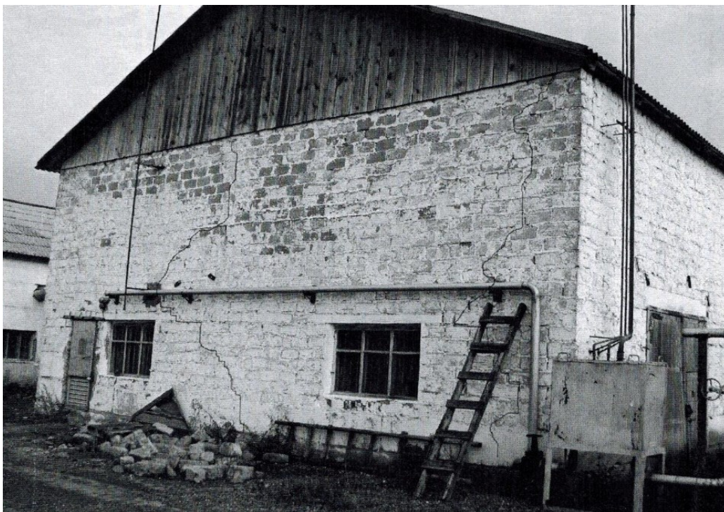
Рис. 8. Трещины на стене здания Fig. 8. Cracks on the building wall
