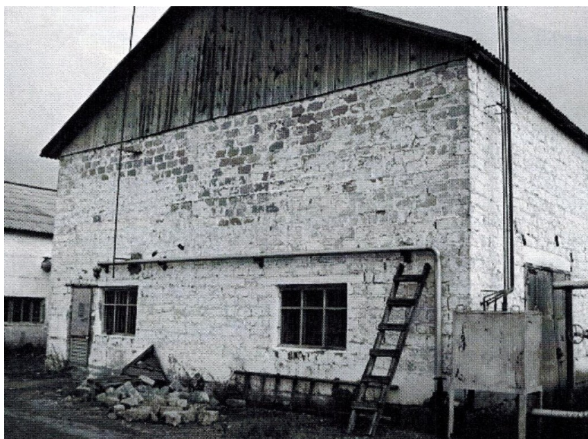
Рис. 2. Фотография фасада здания в осях В–А Fig. 2. Photograph of the building facade in axes B–A
