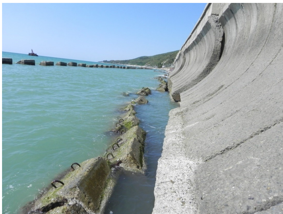
Рис. 8. Разрушающаяся волноотбойная стена на участке 2, 2018 г. Fig. 8. Destroying sea wall on section 2, 2018
