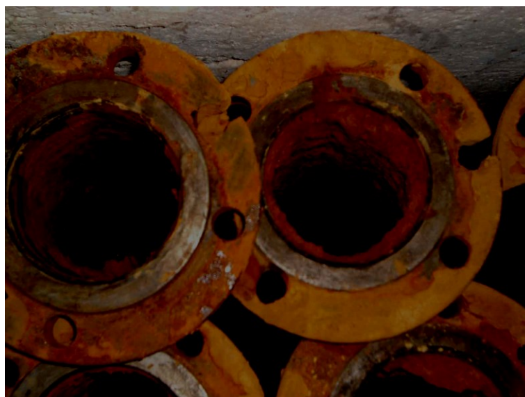
Рис. 1. Водоподъемные трубы артезианской скважины Fig. 1. Water-lifting pipes of an artesian well
