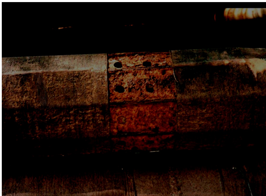
Рис. 2. Фильтр артезианской скважины. Отдельные отверстия фильтра перекрыты кольматантами Fig. 2. Artesian well filter. Individual filter holes are blocked with colmatants
