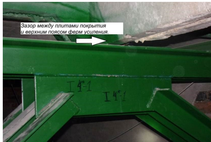
Рис.12. Зазор между верхним поясом ферм усиления и ребрами ж/бетонных плит покрытия Fig. 12. The gap between the upper belt of reinforcement trusses and the ribs of reinforced concrete slabs of the coating
